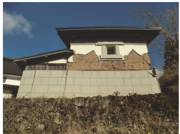
写真 10 家屋の壁の剥離（小谷村真木）
