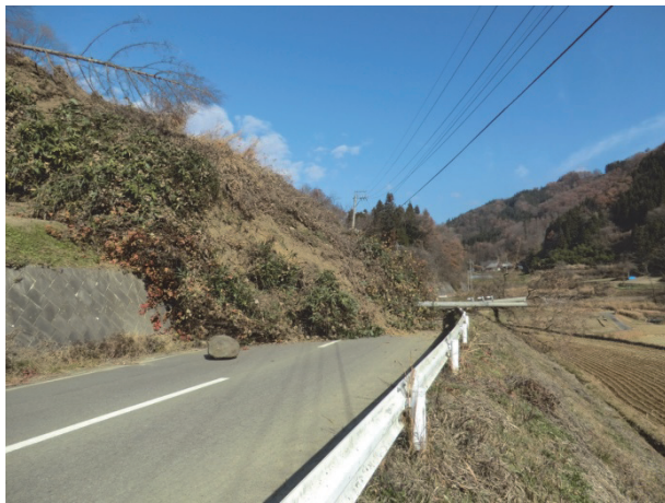
写真 13 道路を塞いだ土砂崩れ （長野市戸隠豊岡）
