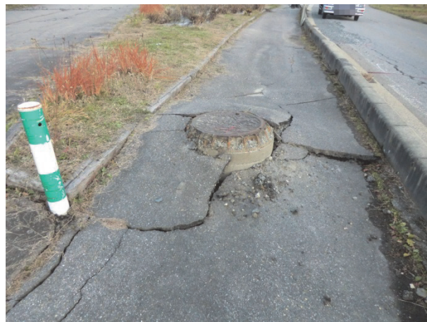
写真 18 液状化により飛び出したマンホール （白马村神城堀之内県道 33 号線）
