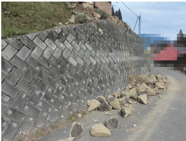
写真 9 石垣上部斜面からの落石（小谷村真木）
