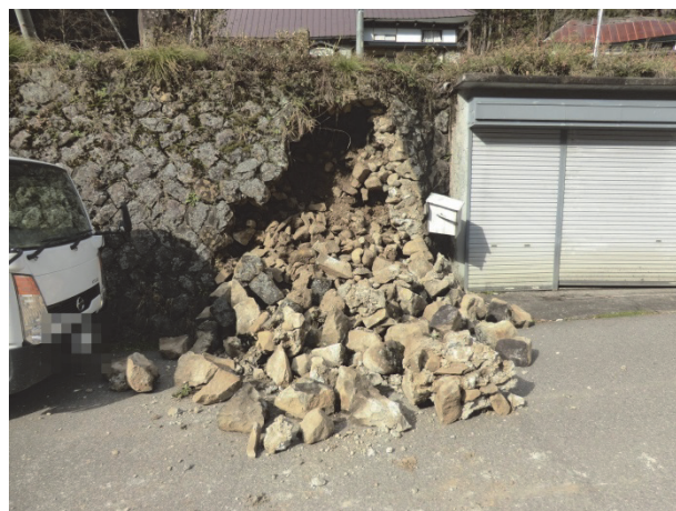
写真 11 道路脇石垣の損壊（小谷村真木）
