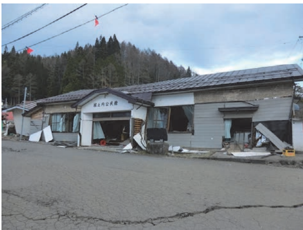
写真 1 公民館の損壊（白馬村神城堀之内）
