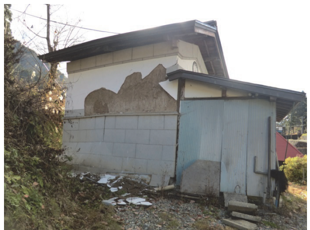
写真 12 納屋の壁の剥離（小谷村真木）
