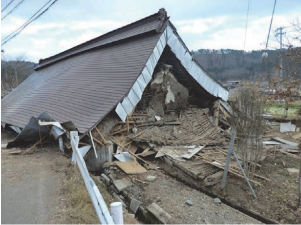
写真 3 家屋の倒壊（白馬村神城堀之内）
