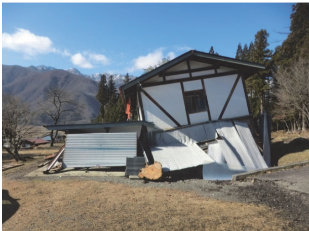
写真7 家屋1階部分の倒壊 （白馬村神城堀之内）
