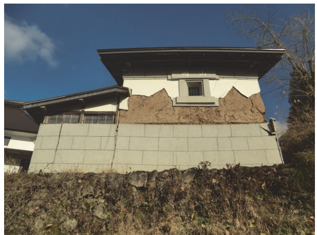
写真 10 家屋の壁の剥離（小谷村真木）
