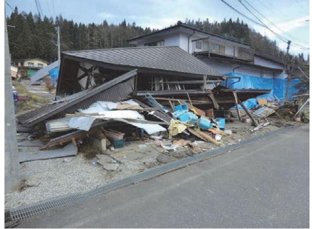
写真4 家屋の倒壊（白馬村神城堀之内）
