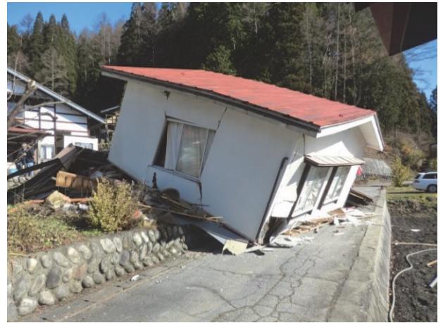
写真6 家屋1階部分の倒壊 （白馬村神城堀之内）
