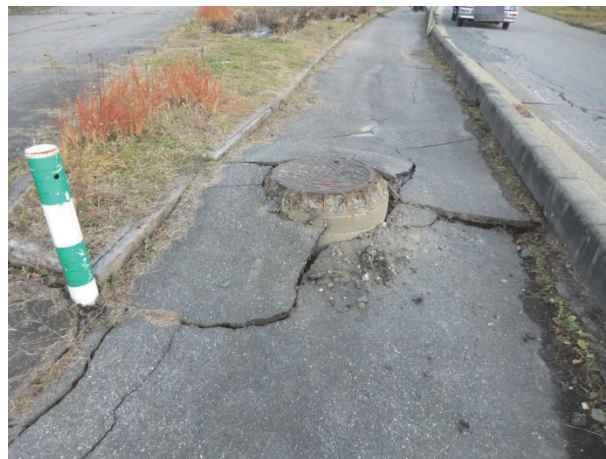
写真 18 液状化により飛び出したマンホール （白马村神城堀之内県道 33 号線）
