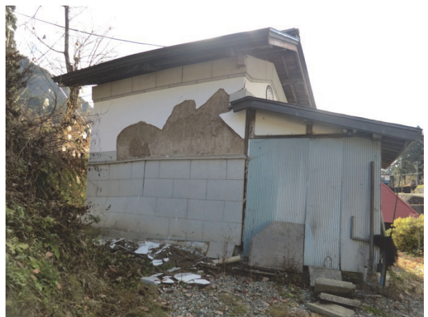
写真 12 納屋の壁の剥離（小谷村真木）
