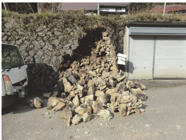
写真 11 道路脇石垣の損壊（小谷村真木）
