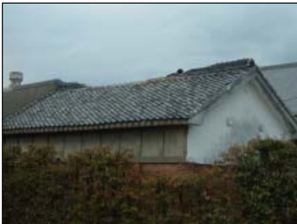
写真 18．瓦の一部が破損した家屋
