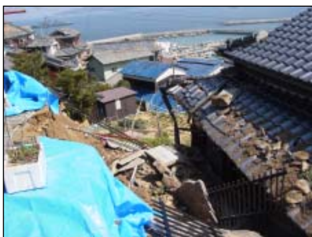
写真 9 . がけ崩れにより損壊した家屋
