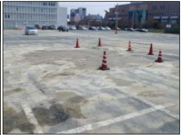
写真 15．液状化により土砂が噴出した跡が見られる駐車場
