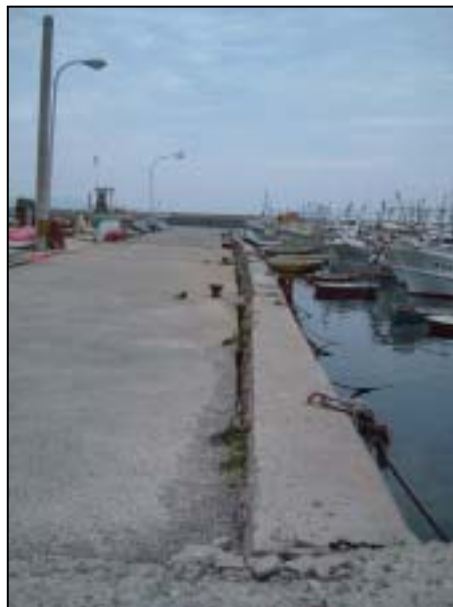
写真2 . 約 40cm 程の段差を生じた岸壁
