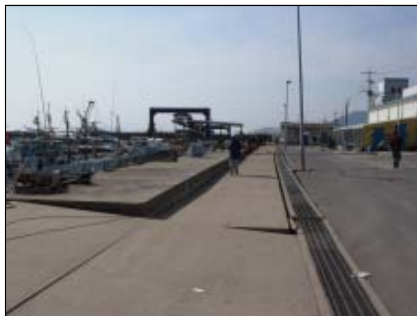
写真4 . 約 40cm 程の段差を生じた岸壁
