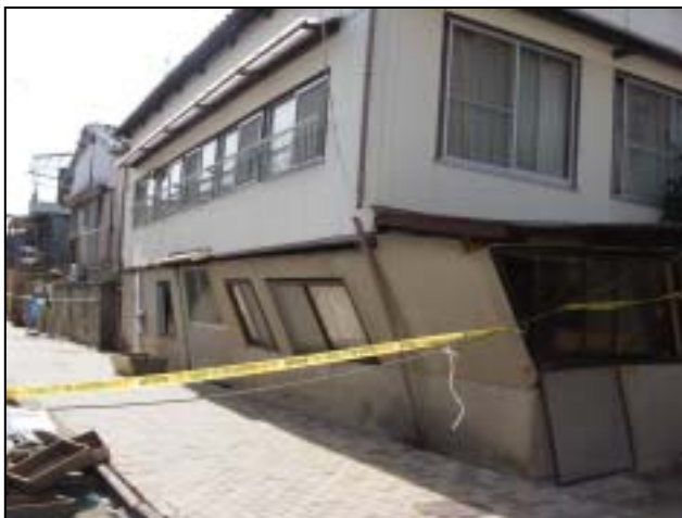
写真5 . 1 階部分が傾いた海岸近くの家屋
