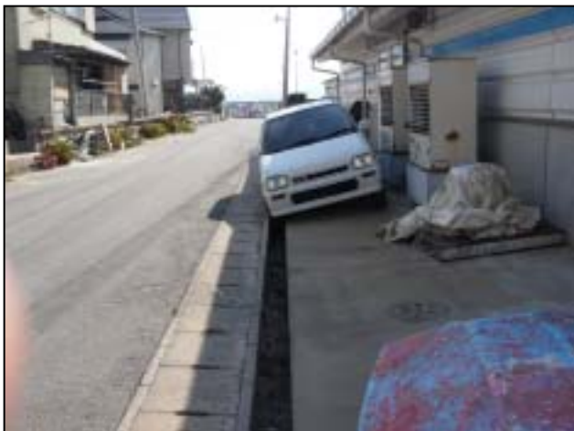
写真1 . 道路側溝脇の約 30cm の亀裂
