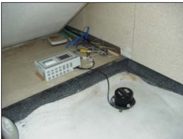
・ 計測震度計設置箇所 漁村センター1 階の階段下
