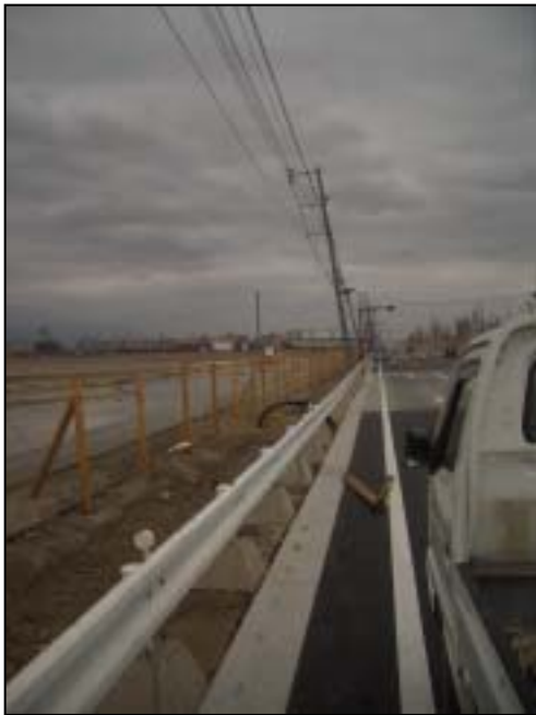
写真 11．道路脇の傾いた電柱
