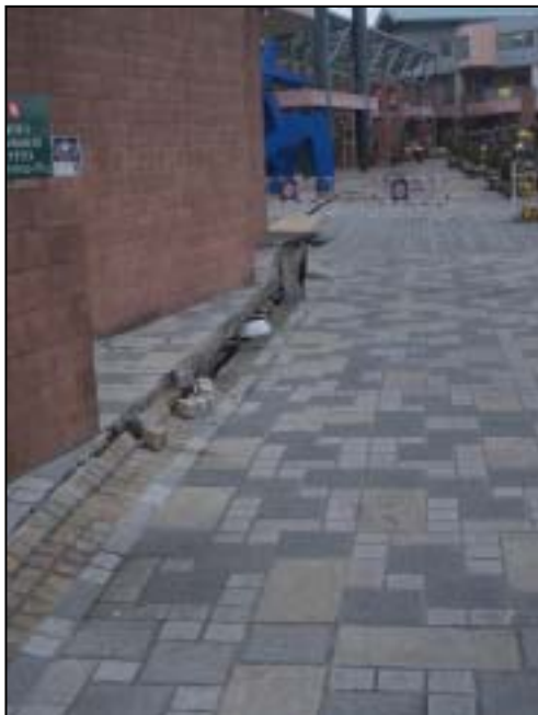
写真 12．20～30cm 陥没した歩道
