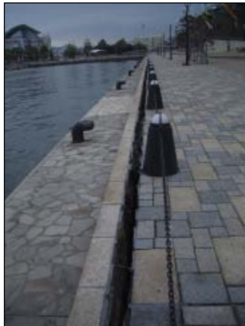
写真 13．約 20cm の亀裂の生じた岸壁
