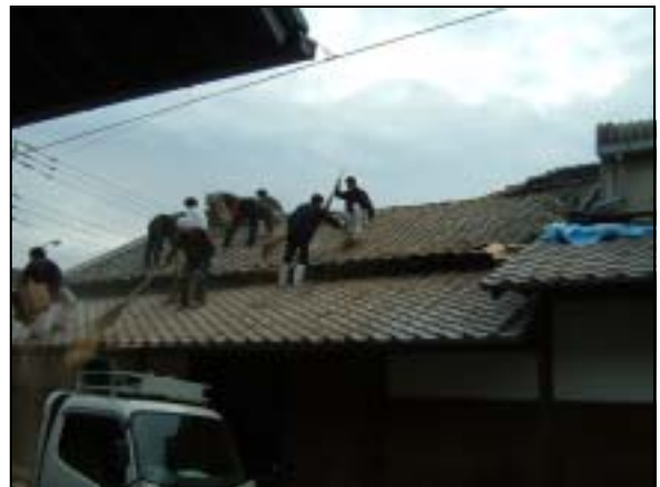
写真 19．瓦の一部が破損した家屋と修復作業の様子
