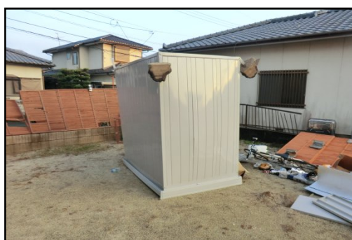
転倒した物置 (撮影方向: 南東)
