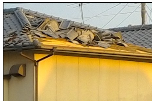
屋根瓦が飛散した住家 (撮影方向: 南東)
