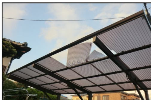
屋根が浮き上がったカーポート (撮影方向: 北東)
