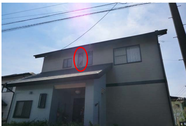
③窓ガラスが破損した住家(撮影方向:南)
