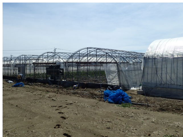
⑫ビニールが飛んだ農業用ハウス (撮影方向:南)
