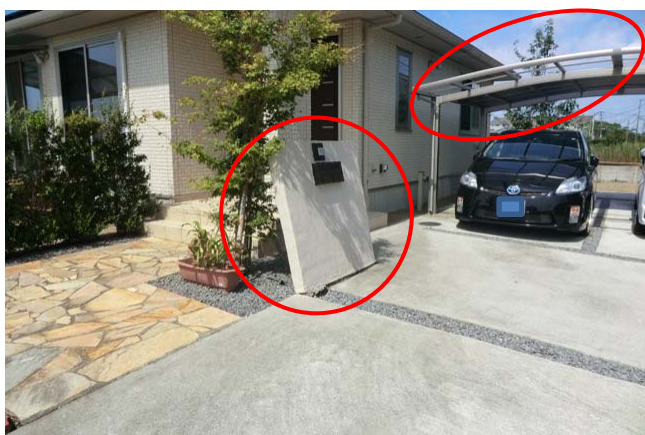
⑦傾いた玄関ブロック塀、破損したカーポート (撮影方向:北東)
