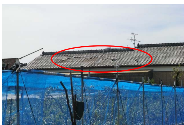
⑥屋根瓦がめくれた住家(撮影方向:南東)
