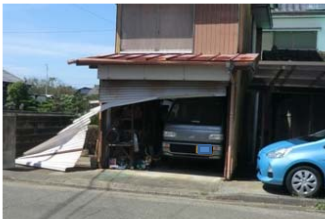
②破損したシャッター(撮影方向:西)
