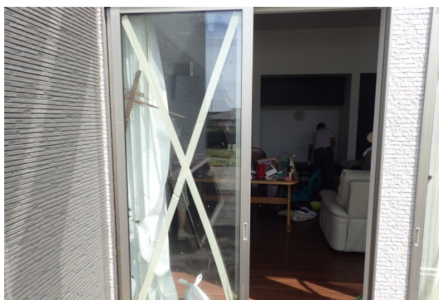
⑧飛散物により破損した住家窓(撮影方向:北)
