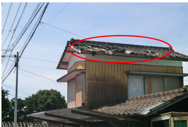
①屋根瓦がめくれた住家(撮影方向:南西)
