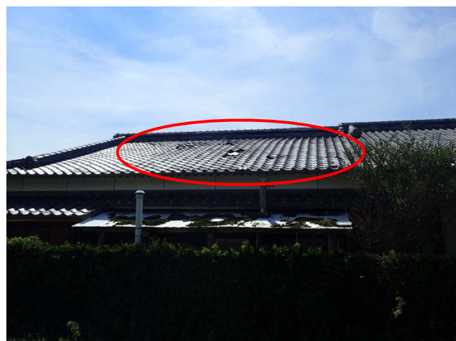
⑩屋根瓦がめくれた住家(撮影方向:南)
