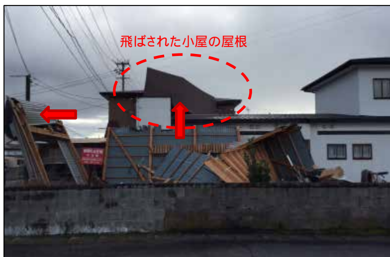
倒壊した物置小屋(北西から撮影)
