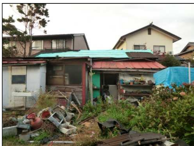
トタン屋根がめくれ落下した納屋 【南方向から撮影】
