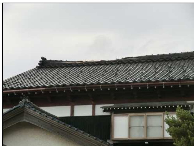
屋根瓦がめくれた住家 【東方向から撮影】
