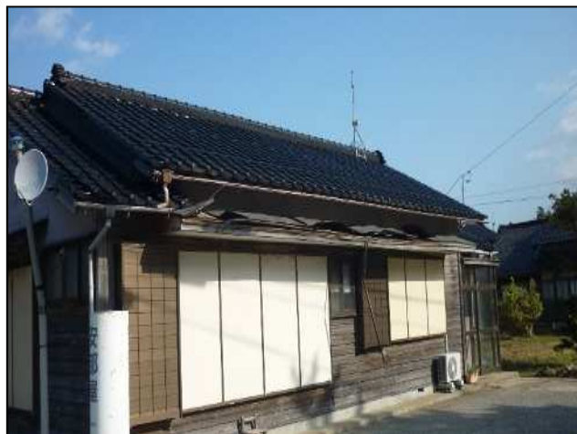
庇のトタンがめくれた住家 【南方向から撮影】(志賀町役場提供)
