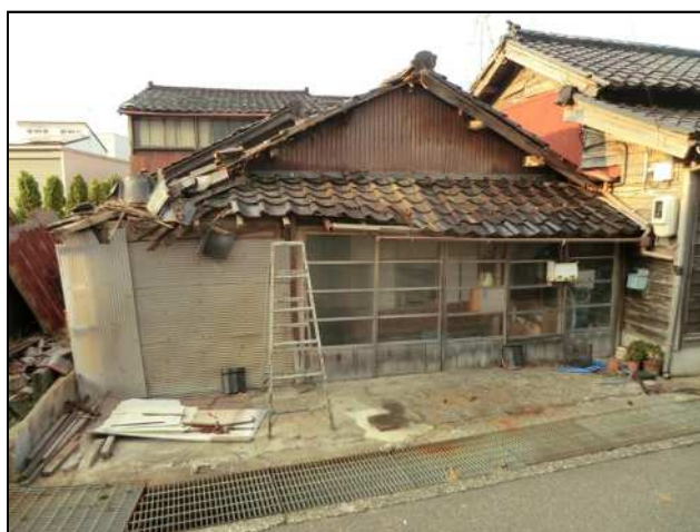
屋根瓦がめくれ落下した住家 【南方向から撮影】
