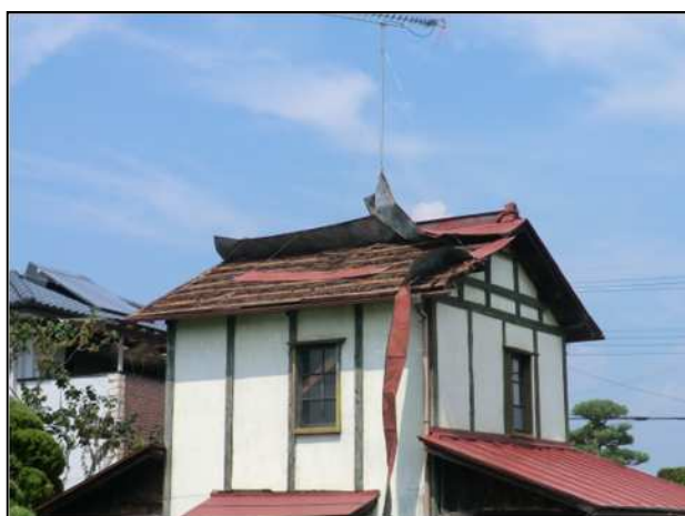
めくれた住家屋根のトタン (南西から撮影)
