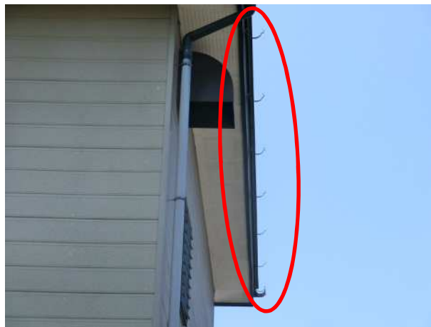
固定部分から外れ飛ばされた 雨どい (北東から撮影)
