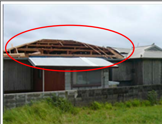
⑧イ地区：屋根のスレートが吹き飛ばされた住家
