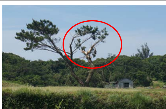
⑨イ地区：調査地点の北端、幹折れした樹木（幹まわりは不明）
