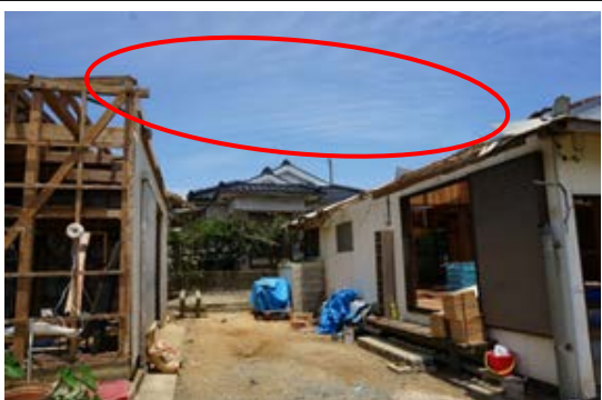
③ア地区：小屋（左側）との間にあったカーポートの屋根が飛散した住家
