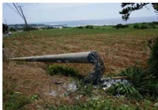
②ア地区：倒壊したコンクリート電柱
