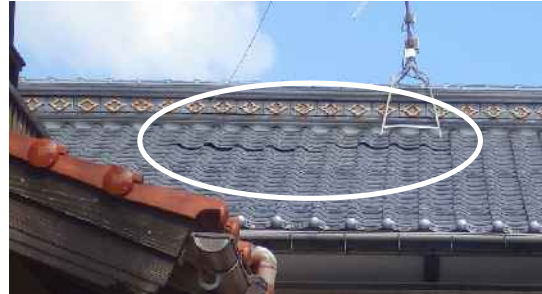
屋根瓦がずれた住家。
