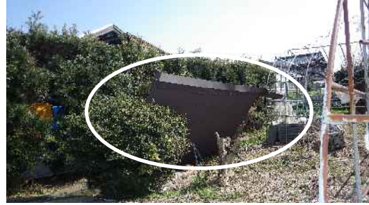
飛散した倉庫の屋根 西側約 50 メートル先から飛散した。
