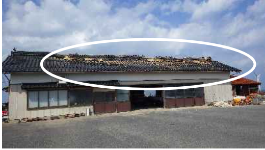
屋根瓦が飛散した事務所兼倉庫 屋根瓦が飛散し 40 メートル南南東の駐車場まで飛んだ。瓦は駐車してあった自動車数台の窓ガラスを破損した。
