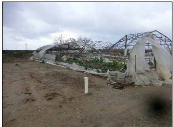
一部損壊したビニールハウス (南南西から撮影)
