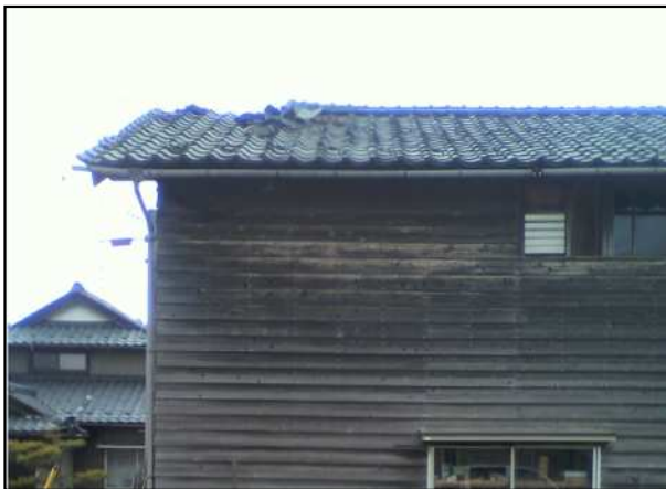
屋根瓦がめくれ、落下した住家 (北から撮影)
