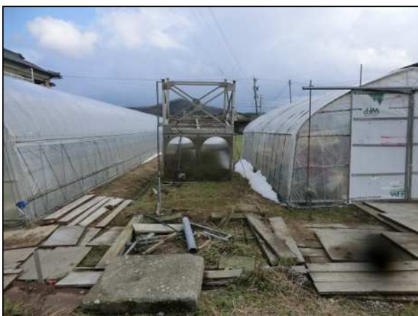
転倒した水槽タンク (西から撮影)
