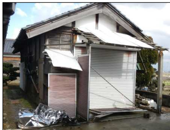
トタンがめくれた非住家 (南西から撮影)
