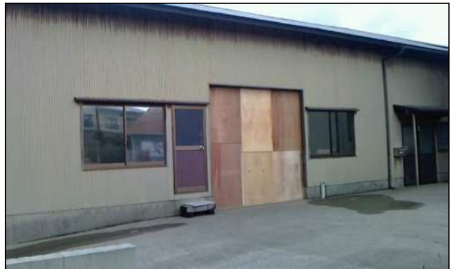
シャッターが破損した倉庫 (西から撮影)
