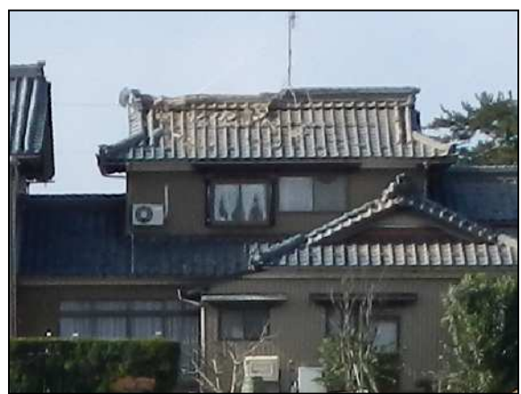
屋根瓦がめくれ、落下した住家 (東から撮影)
