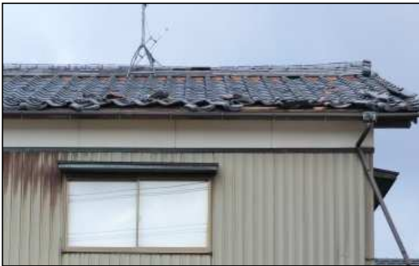
屋根瓦がめくれた住家 (西から撮影)
