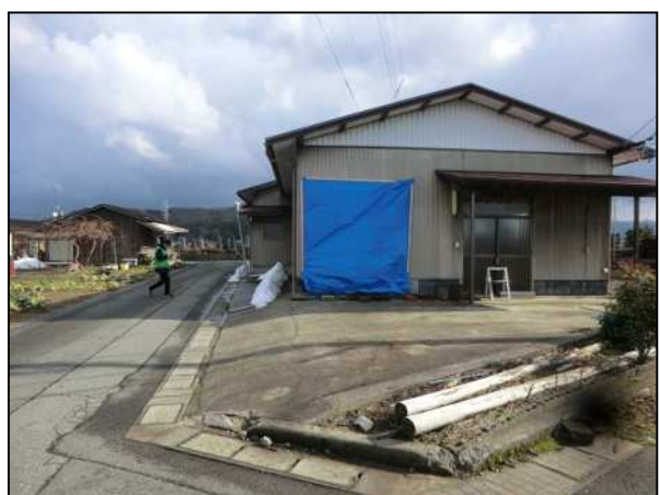
シャッターが破損した非住家 (西から撮影)
