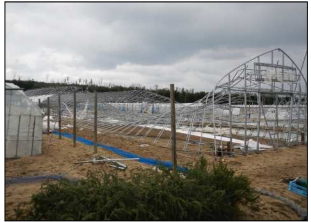
倒壊したビニ - ルハウス (南から撮影)
