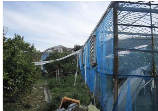
図 3-4 写真④ ビニールの飛散したビニールハウス
