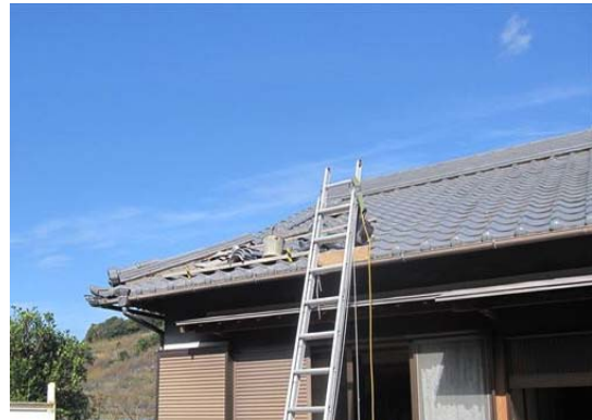
図 3-2 写真② 屋根瓦がめくれた住家
