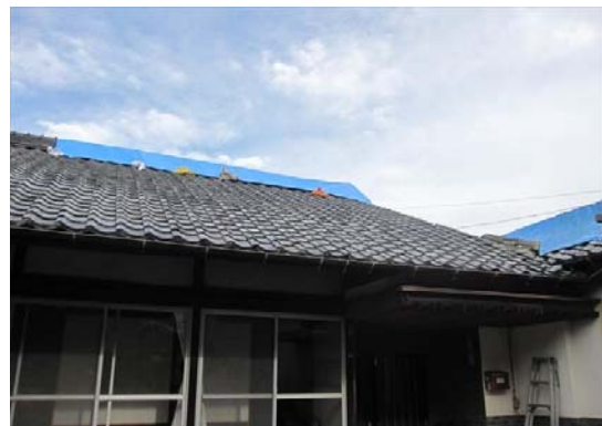
図 3-6 写真⑥ 屋根瓦がめくれて落下した住家
