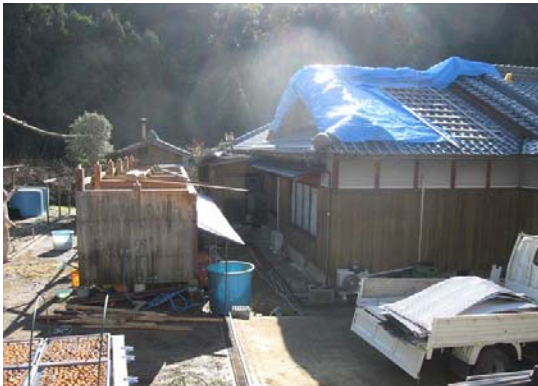
図 3-1 写真① 屋根の飛散した倉庫と屋根瓦がめくれた住家
