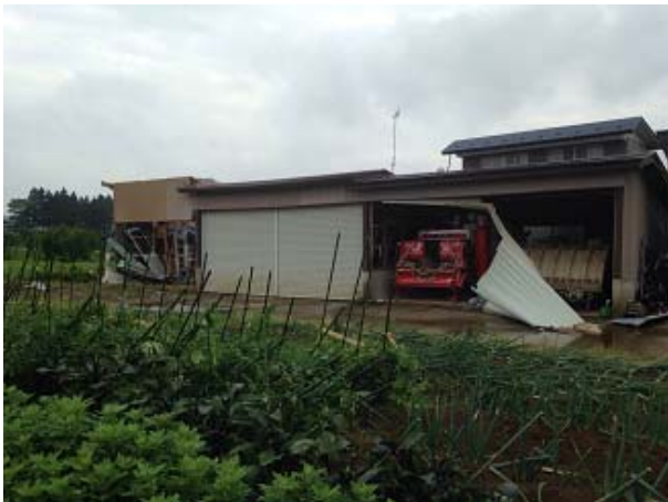
③屋根が飛散し、シャッターが損壊した非住家（倉庫）。（北東から撮影）
