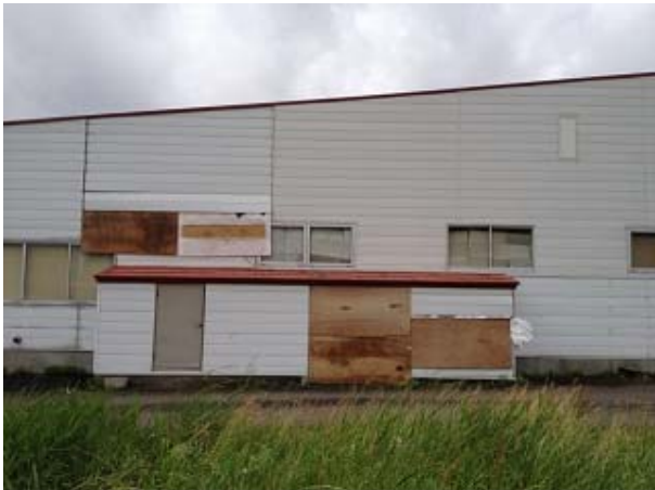
①東側壁のトタンが東側へ約 10m 飛散した非住家。（東から撮影）
