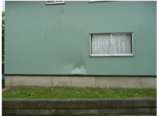
②北西側壁に飛散物による痕跡ができた非住家（倉庫）。（北西から撮影）
