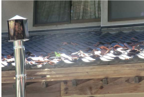
④ 屋根瓦がめくれた住家
