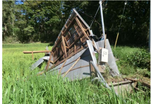
② 倒壊したポンプ小屋
