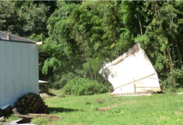
③ トタン屋根が約20m飛散した納屋
