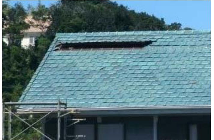
②屋根瓦がめくれた住家
