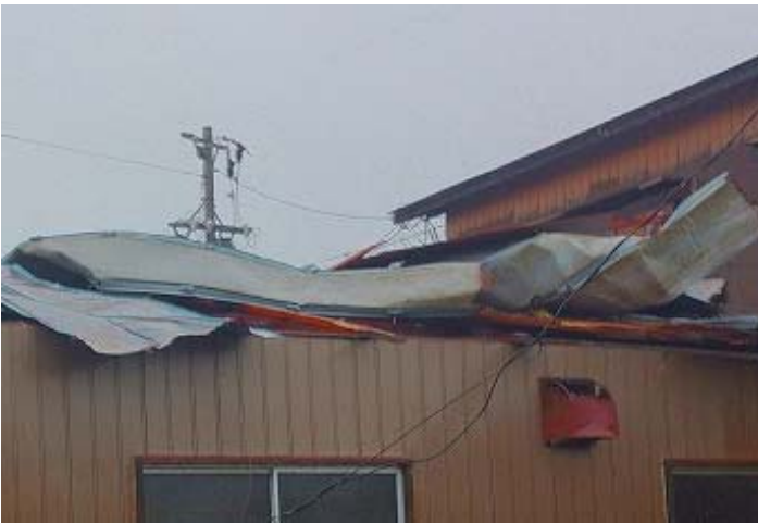
③屋根のトタンがめくれた非住家 【志摩市提供】
