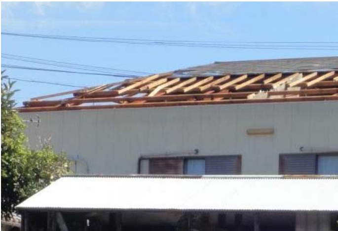
①スレート屋根が飛散した住家
