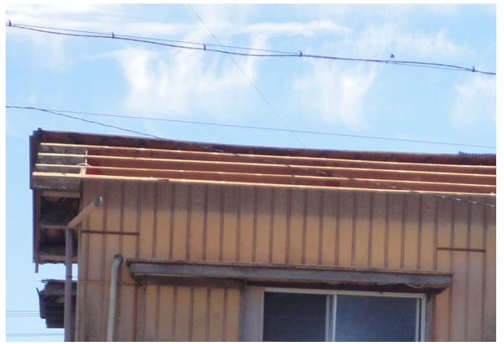
④屋根が飛散した住家
