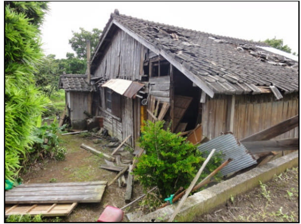
②非住家の壁と屋根瓦の損壊(北東側から撮影)
