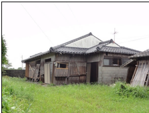
⑤非住家の損壊(東側から撮影)
