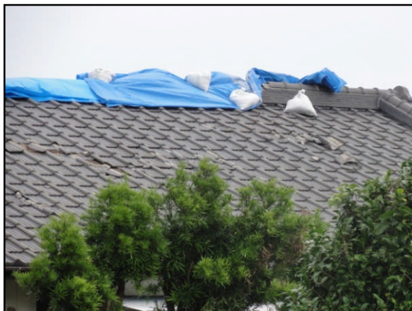
⑦住家の屋根瓦の飛散(北側から撮影)
