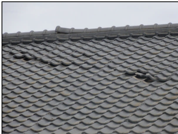
③屋根瓦の捲れ(北側から撮影)
