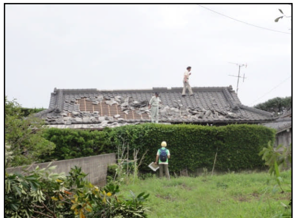
⑥住家の屋根瓦の落下(北側から撮影)
