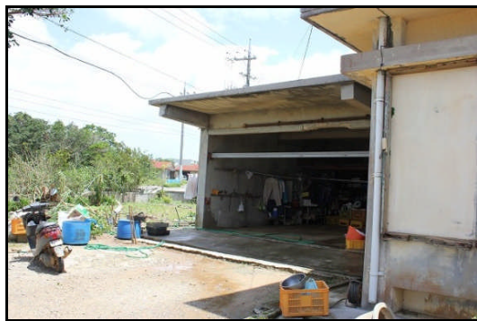
③ 倉庫の引き戸が吹き飛ばされた民家
