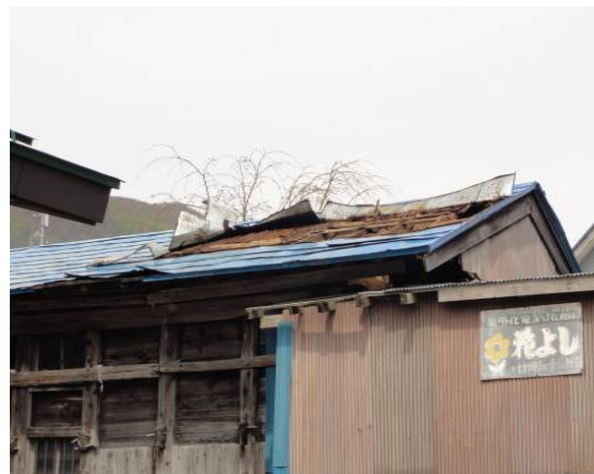
④ 屋根が剥離した物置小屋 (南西から撮影)
