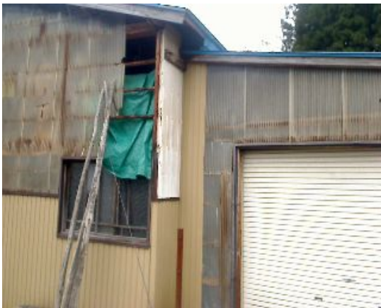
⑪ 外壁が剥離した物置小屋 (南から撮影)
