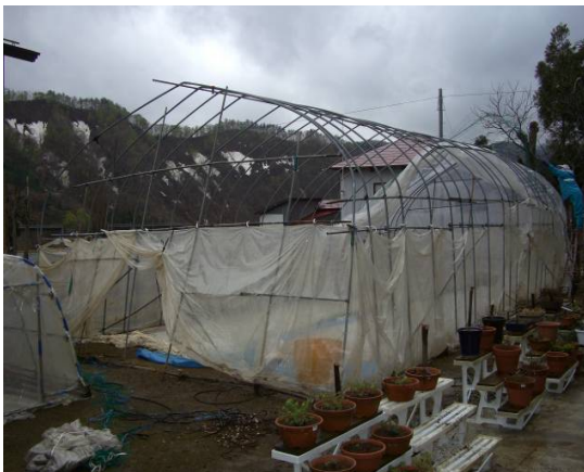
③ 破損したビニールハウス (東成瀬村役場提供：北東から撮影)
