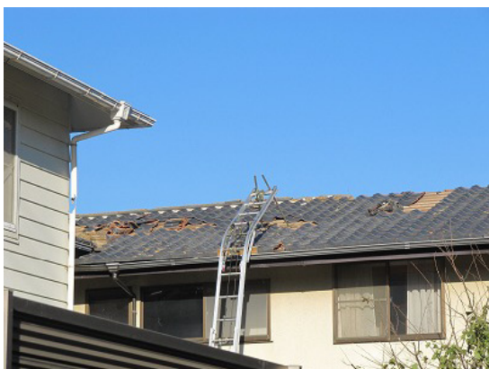
③屋根瓦が剥がれた住宅【南西から撮影】
