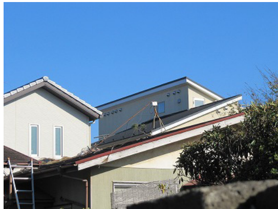
②倒れたテレビアンテナ【西から撮影】
