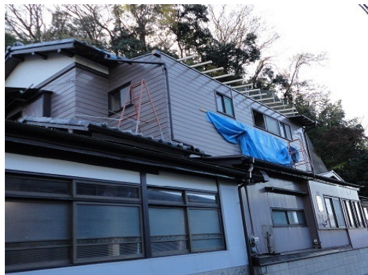
④破損した屋根【北から撮影】
