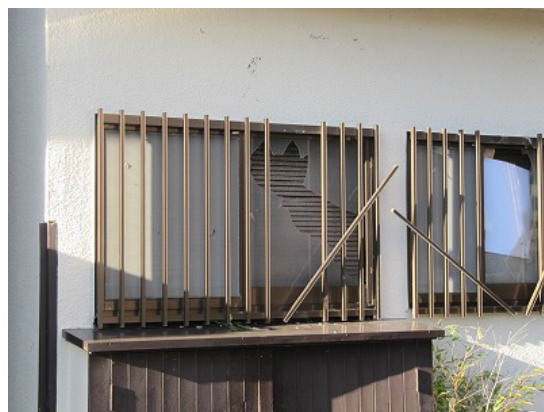
④飛散物により割れた窓ガラス 【南南西から撮影】
