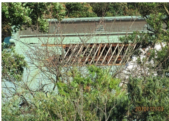
⑤屋根（銅葺）が一部破損した寺院 【西から撮影】
