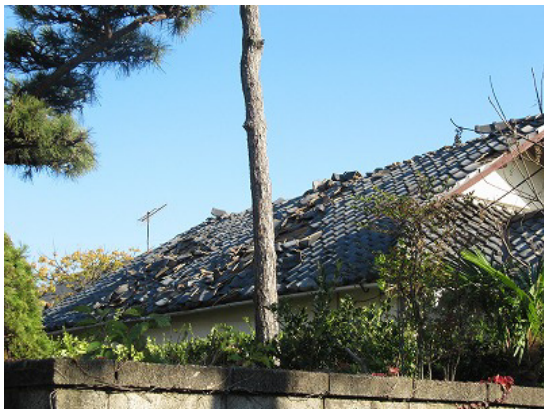
①屋根瓦が剥がれた住宅【西北西から撮影】
