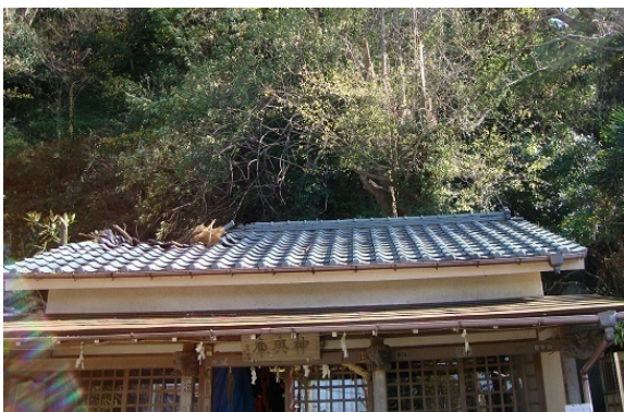
③倒木により破損した屋根 【西から撮影】
