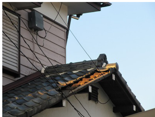
⑥屋根瓦が剥がれた住宅【南から撮影】
