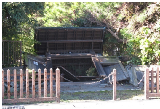
②倒れた門【東から撮影】
