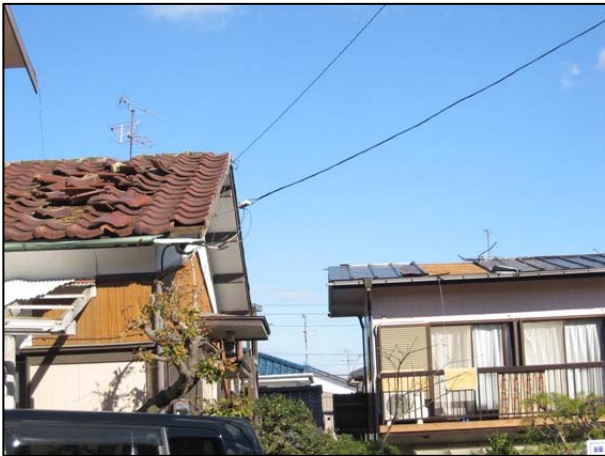
① 屋根瓦の剥離及びテレビアンテナの転倒【南から撮影】
