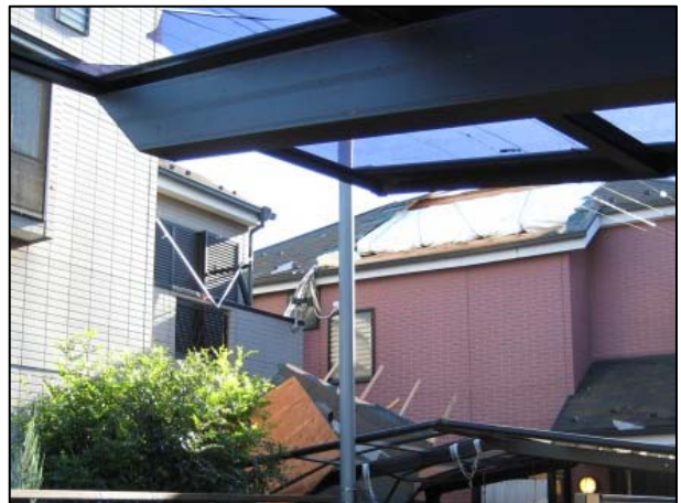
② 半壊した住家【西北西から撮影】
