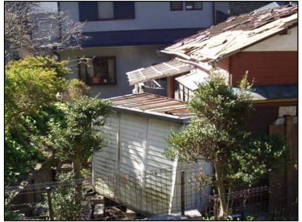
④ 移動した物置及び屋根瓦の剥離【東北東から撮影】
