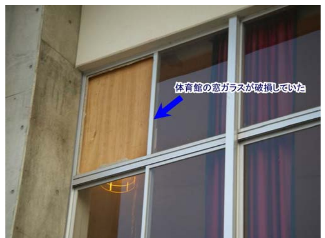
6 体育館窓ガラス破損(拡大)
