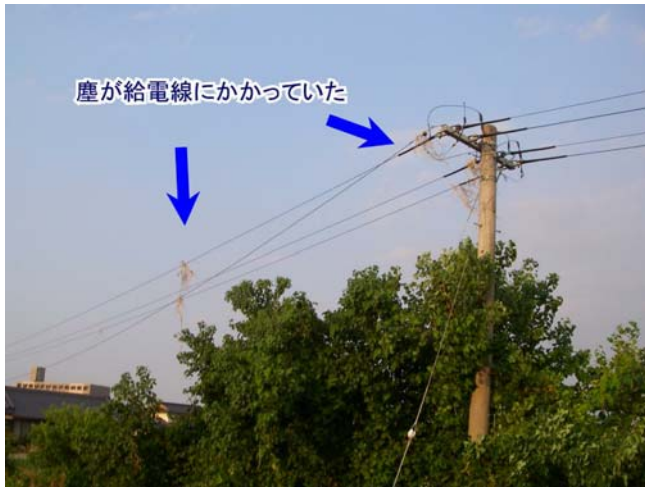
7 給電線にかかった塵
