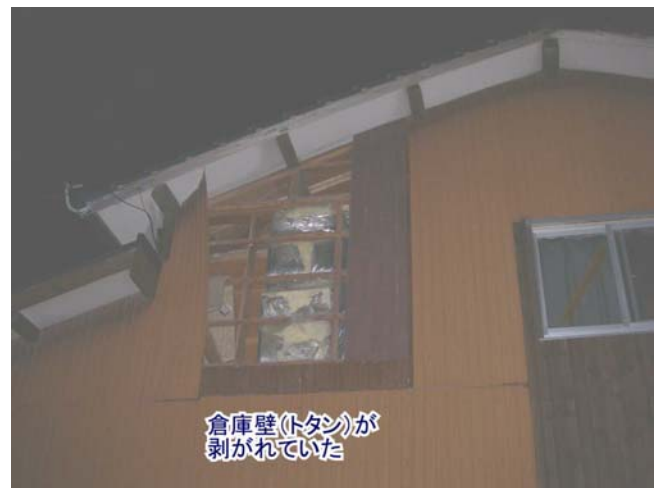
10 倉庫壁(トタン)が剥がれていた
