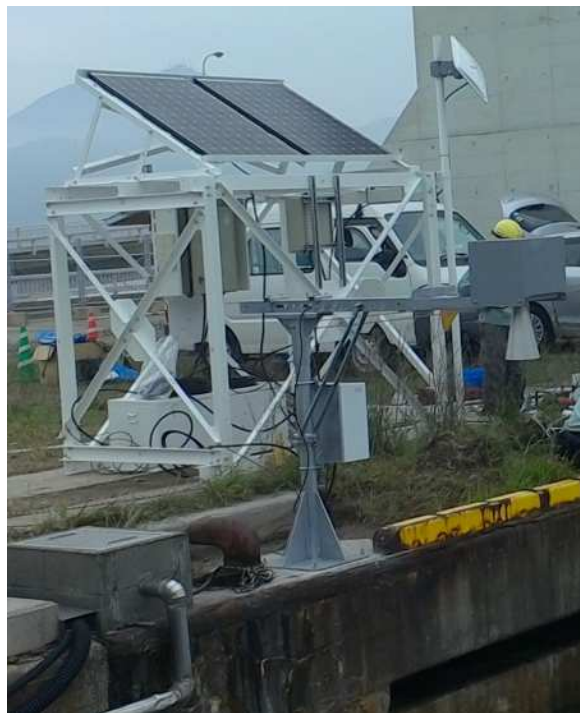
今般設置した機動型津波観測装置
