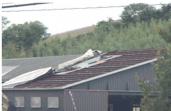
⑦屋根の剥離
