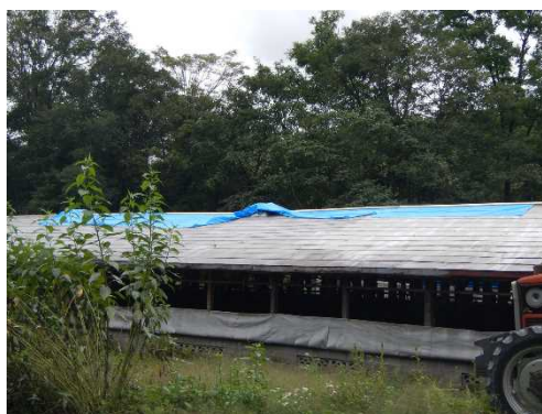
④屋根の損傷
